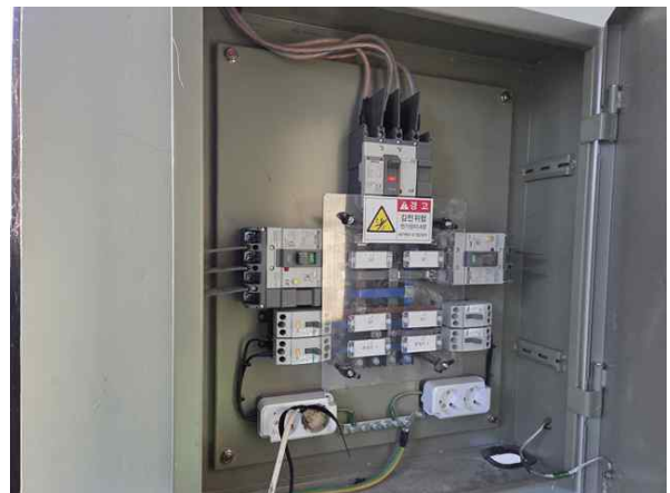
<전기실 전력 배전반 상태양호>
