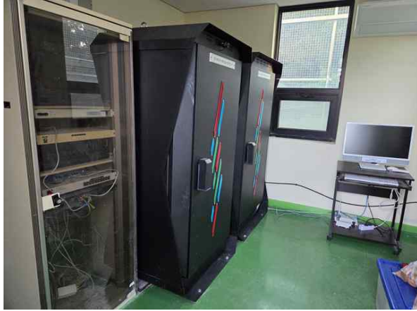
<전기실 전기설비 상태양호>
