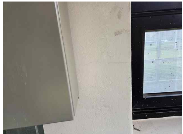
<전기실 내부 벽체 균열>
