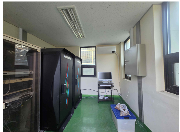
<전기실 내부 전경>
