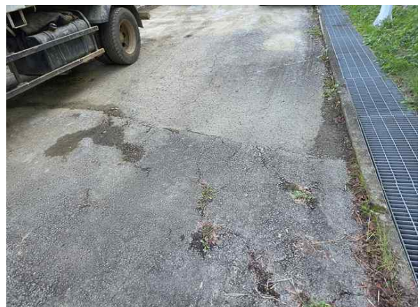
<부대시설 배수지 장내 포장부 균열>
