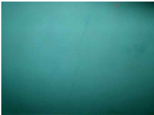
<배수지 2지 벽체 균열(0.3mm미만)>
