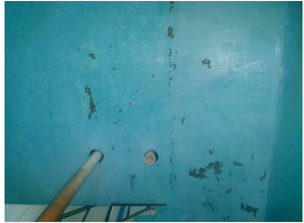
<배수지 2지 상부슬래브 도장박리>
