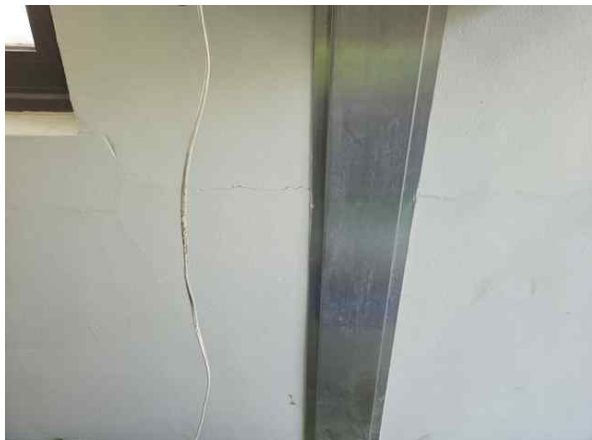
<전기실 내부 벽체 균열>
