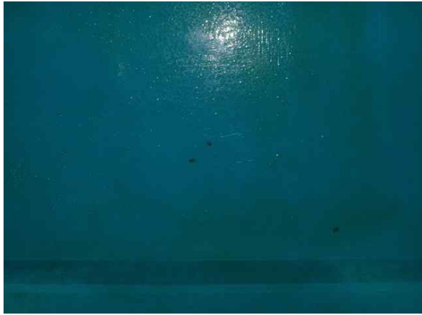
<배수지 2지 상부슬래브 녹물>
