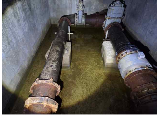
<유량계실 밸브, 배관, 볼트류 부식>
