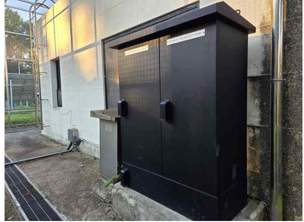
<검수실 외부 전기설비 상태양호>
