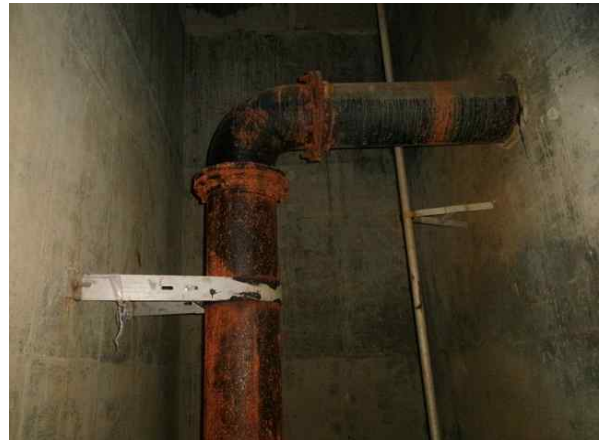
<통합밸브실 유출 밸브, 배관, 볼트류 부식>
