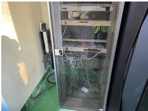
<전기실 전기설비 상태양호>
