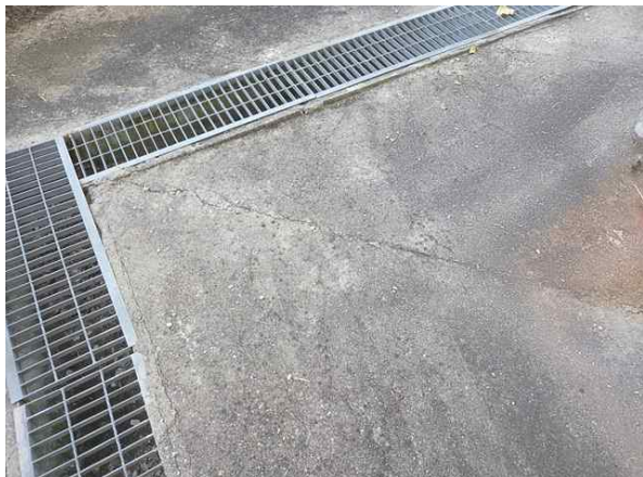
<검수실 외부 바닥기초 균열>
