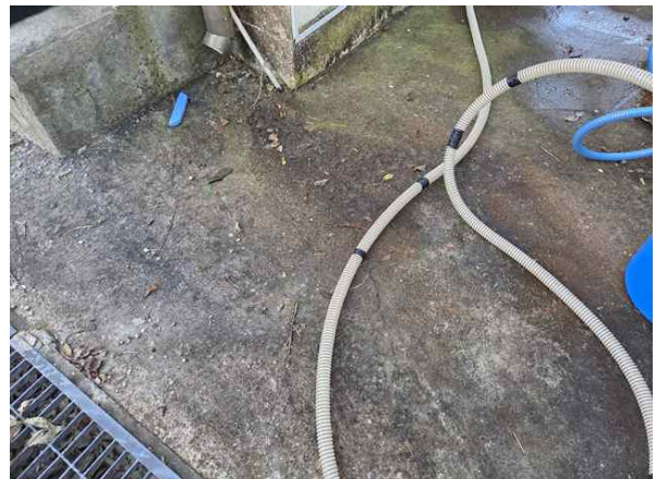
<검수실 외부 바닥기초 균열>
