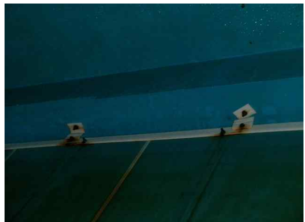
<배수지 1지 도류벽 브라켓 파손>
