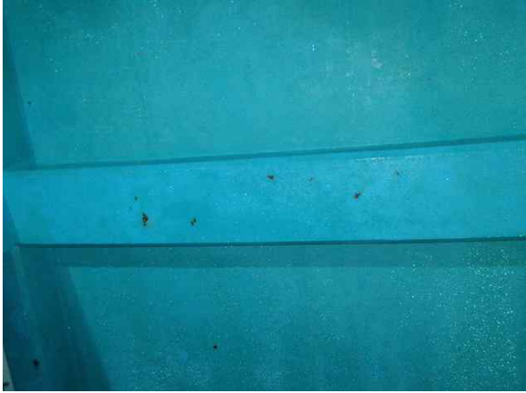
<배수지 1지 상부슬래브 녹물>
