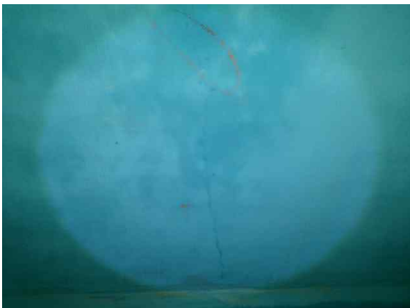
<배수지 1지 벽체 균열(0.3mm미만)>
