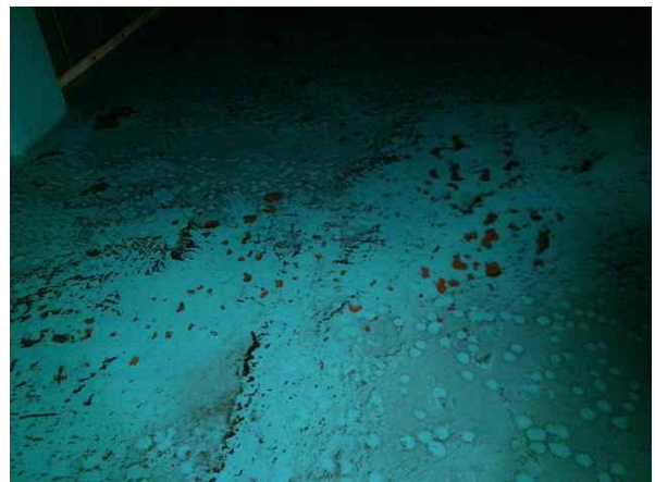
<배수지 1지 바닥슬래브 도장박리>
