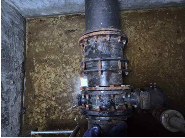
<1지 유입 밸브, 배관, 볼트류 현황>
