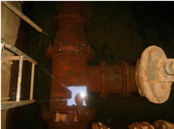
<통합밸브실 유출 밸브, 배관, 볼트류 부식>
