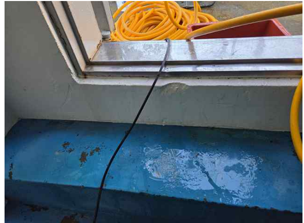
<검수실 내부 배면 벽체 파손>
