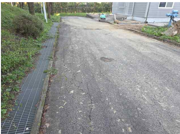
<부대시설 배수지 장내 포장부 균열>
