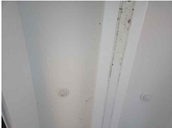
<검수실 내부 상부슬래브 도장박리>
